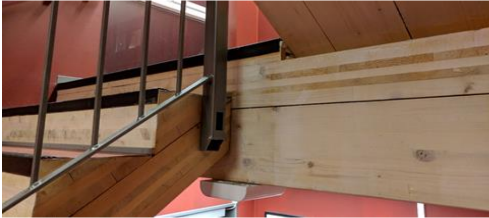
Figur 25: Krysslimte massivtreelementer som etasjeskiller og bærende konstruksjon i gulv og trapp. Bildet er tatt i Pentagon studentby ved NMBU i Ås.
