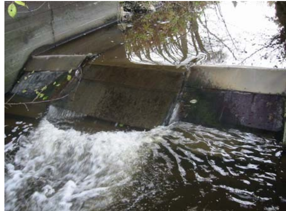
Terskel i dårlig stand (Foto: J. Deelstra).
