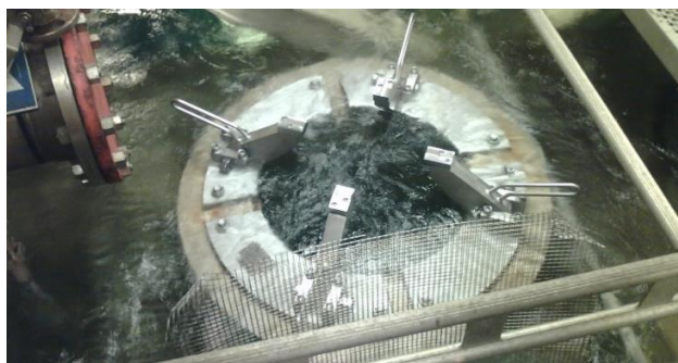
Figur 4.3: Bilde hentet fra installasjon av brannpumpesystem ved Draugen plattformen i 2015. «Hang-off-toolet» er installert på nederste dekk og dekket av sjøvann. Foto: Eureka Pumps AS.
