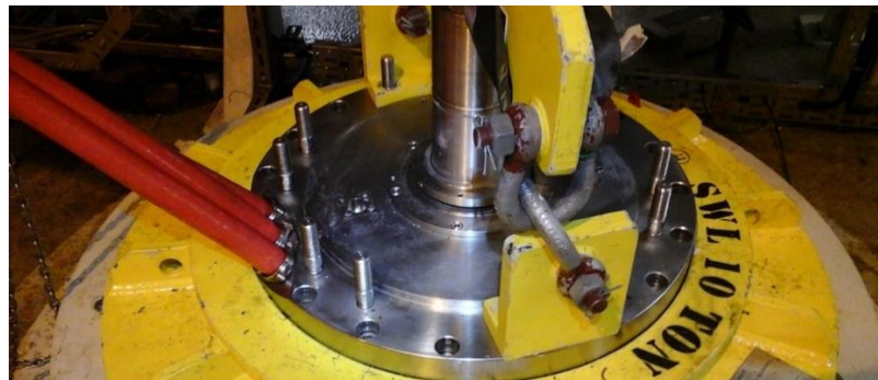
Figur 4.5: Tre enkeltfasekabler fastspent til el-motoren som skal føres ned i sjøen. Foto: Eureka Pumps AS.
