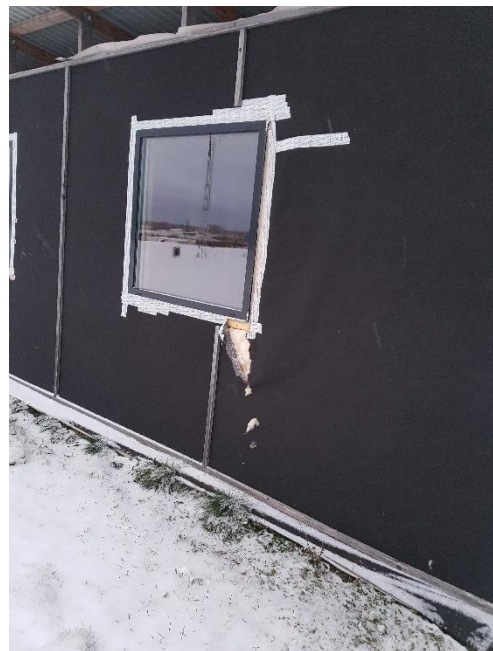
Figur 5.1. Ødelagt vindspærre på modul A (Foto: Georg Thorsnes)
