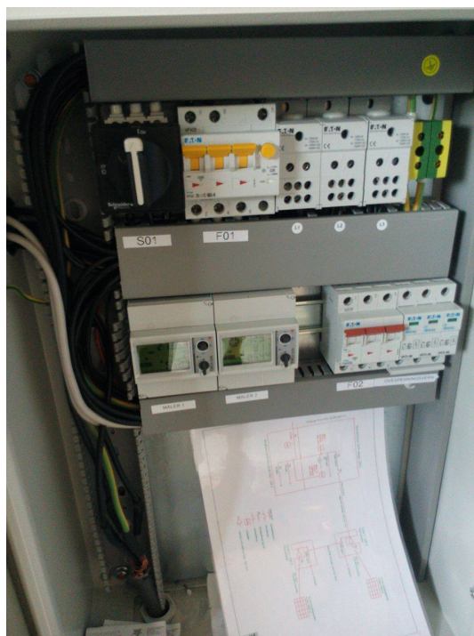
Figur 4.3: Hovedtavle for anlegget i bunkeren. Dette er ett av to målepunkter som ble benyttet i denne oppgaven.
