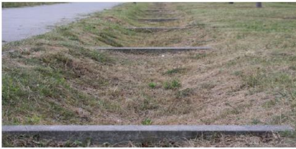
Figur 17: En grønn grøft med hinder for å holde vann tilbake til infiltrasjon og fordrøyning. (VA-Miljøblad nr: 106, 2013)
