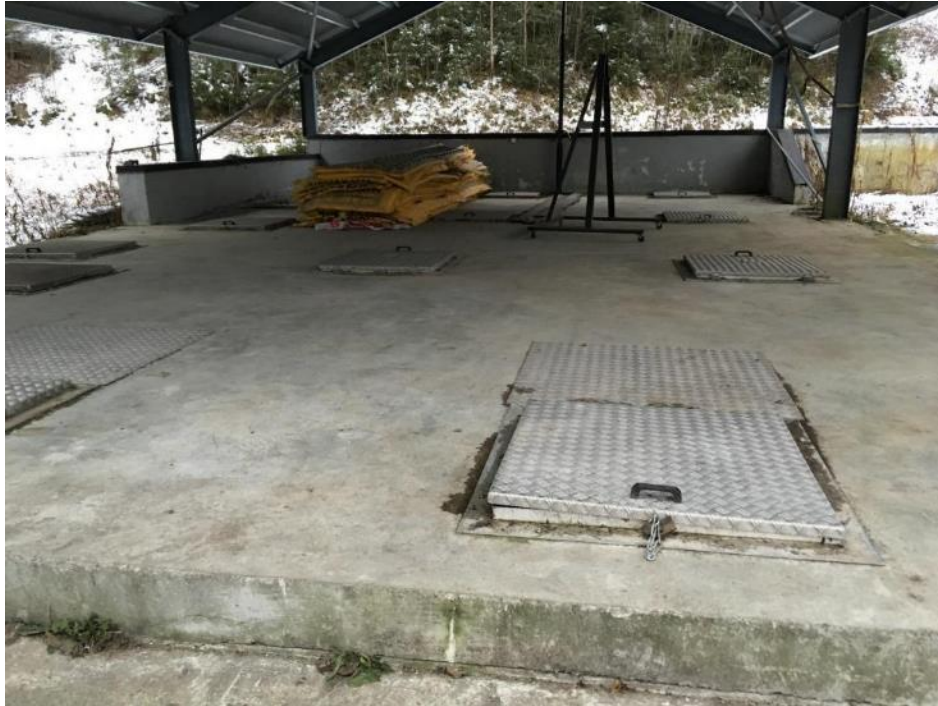
FIGUR 3.11 BETONG ELEMENTER FRA DET GAMLE RENSEANLEGGET NÅ I BRUK SOM SLAMAVSKILLER (IMP).
