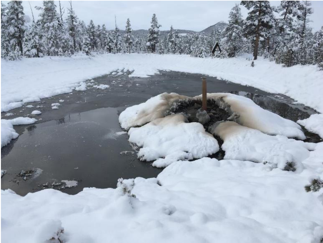
FIGUR 3.14 BASSENG 1 VED FOLLDAL RENSEPARK I DRIFT (NOVEMBER 2016, IMP).
