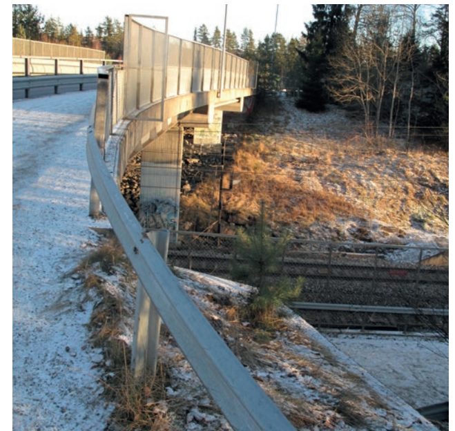
Figur 102: Bro på Myrvoll, tungvint å måtte gå under, tilbake, for så å krysse.”
