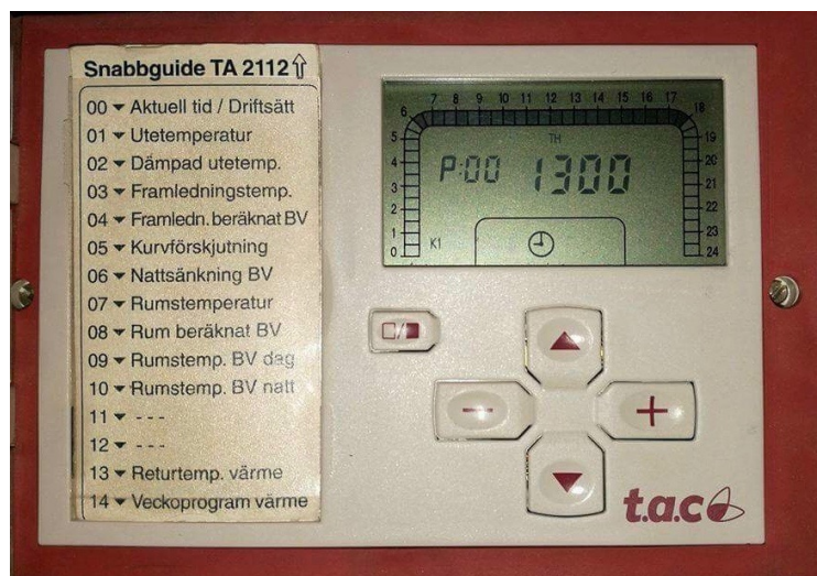
Figur 3.4: Regulatoren i bygg 2, av typen TAC 2112. Fyringskurven til bygget ble forskjøvet ved å endre turtemperatur. (Foto privat)
