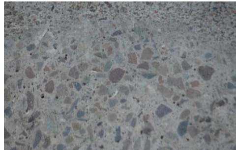
Figur 38: Overflaten av støpt betong
