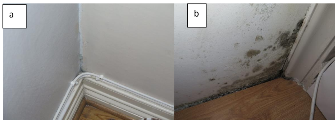
Figur 47 a-b. Skadesak 3.7. Muggsoppvekst på yttervegg. Bilde: Mycoteam
