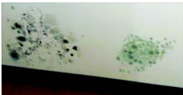
Figur 6 Vekst av muggsopp på gipsplate. Bilde: Mycoteam.
