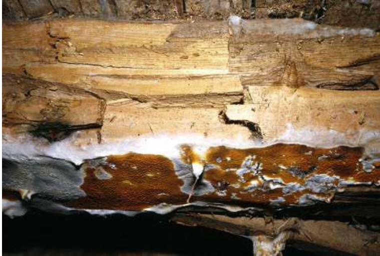
Figur 7 Råtesoppskade i gulvbjelke forårsaket av ekte hussopp. Bilde: Mycoteam.
