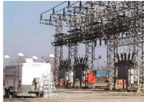
Figur 3.7: Et eksempel på en transformatorstasjon. Bildet er hentet fra [2].
