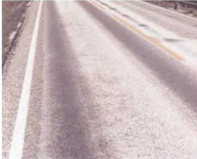
Figur 2.1.5: Bilde av blødning på asfaltdekke. Kopi av figur 1, seksjon 5.3 (Vegdirektoratet 2014b)
