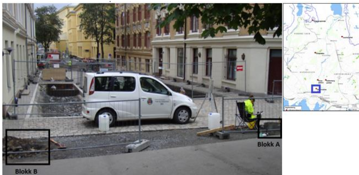
Figur G.1. 1: Forsøksfeltet i Deichmansgate med blokk A og blokk B inntegnet. Oversiktskart øverst til høyre viser beliggenhet av lokalitet
