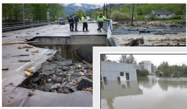
Flommen har ført til store skader på veinettet, spesielt i Hedmark. FOTO: LARS ERIK SKREFSRUD / LARS ERIK SKREFSRUD
