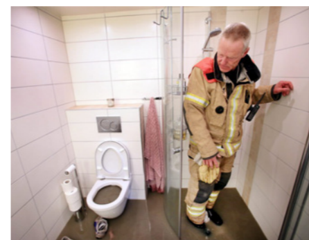
Bilde 7 Brannvesenet hadde en venteliste på 27 overfylte kjelleroppdrag i Asker og Bærum grunnet oppstuvning i avløpsledningen etter et styrtregn. Her er de i en kjellerleilighet på Nesbru. Foto: Karl Braanaas
