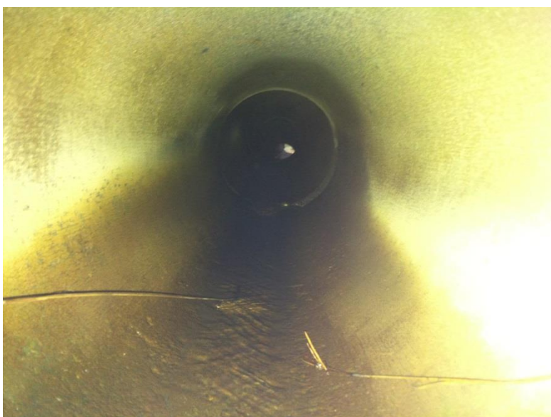
Bilde 3: Skade med fraglidning i betongrør. Foto Kristofer Tveiterå
