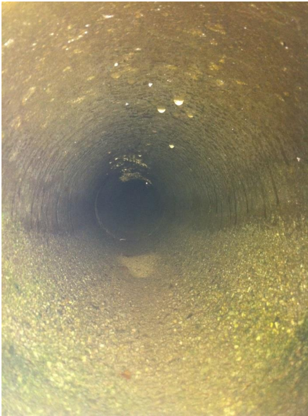
Bilde 1: Skade med buet rør. Foto Kristofer Tveiterå
