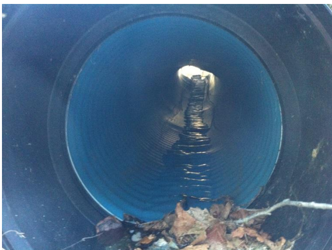
Bilde 1: Skade med sammentrykt rør, Foto Kristofer Tveiterå
