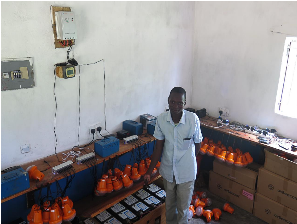
Figur 7 Charge operator på innsiden av en batteriladestasjon. (eget foto)
