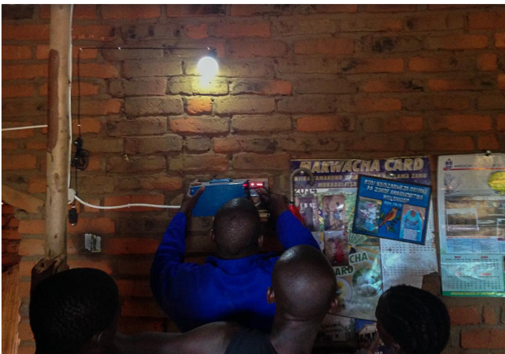
Figur 8 Installasjon av hjemme-anlegg - Sikker tilgang til strøm i hjemmet for første gang! (eget foto)
