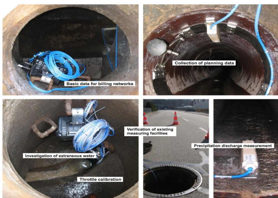
Figur 34: Bildet viser hvordan vannmålerne er montert (nivus 2012).
