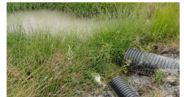
Utløpsrør til resipient.
