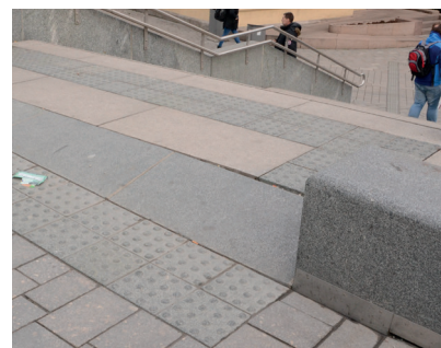
Figur 4.100 Farefelt i toppen av trappen, samt farefelt mot ujevnt dekke rett før trappen.
