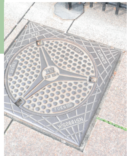
Figur 4.77 Fugebredden mellom kum og dekke er 30 mm på det meste (høyre side på bildet).
