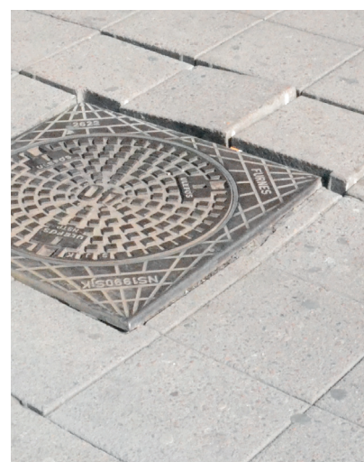
Figur 4.82 Et av kumlokkene ved bussholdeplass D stikker opp over overflatedekket. Noen av de tilliggende hellene ligger også skjevt.
