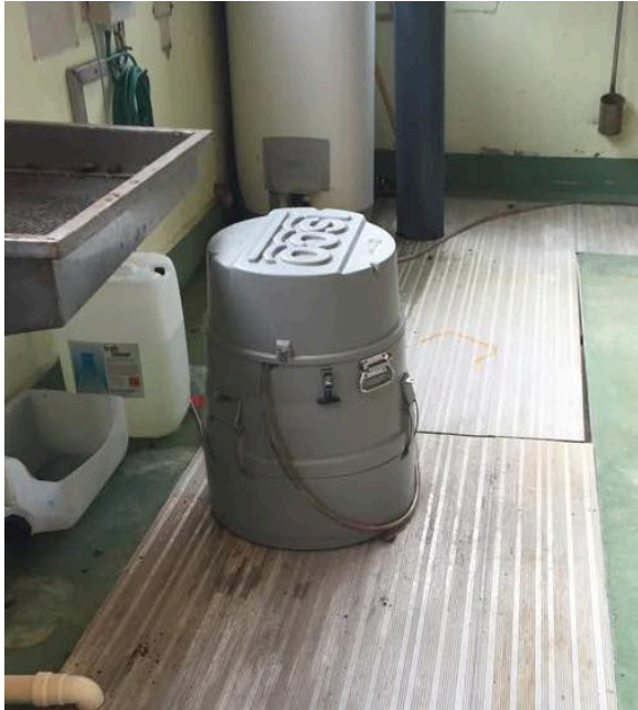
Figur 4 - Isco prøvetaker plassert ved utløpet ved Remmen avløpsrenseanlegg
