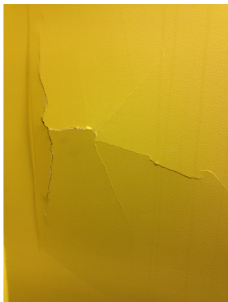
Figur 1.1-6: Utbuling i gipsoverflate
