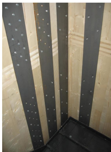
Figur 3.2-2: Stålbeslag i trappesjakt. Bildet er tatt før gipsplater er festet utenpå (Foto: Lars Christian Mørch)
