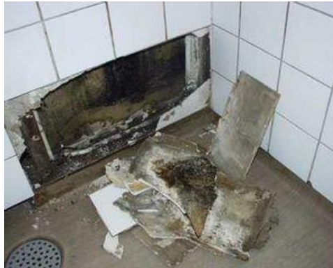
FIGUR 9 - VANNSKADE I BADEROM (DINSIDE.NO 2012)
