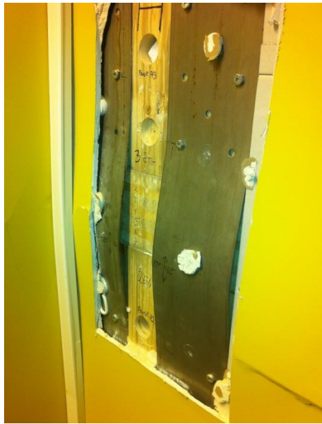
Figur 1.7: Deformert stålplate (utbuling) i heis- og trappesjaketen. Foto: (Nygård, A.)
