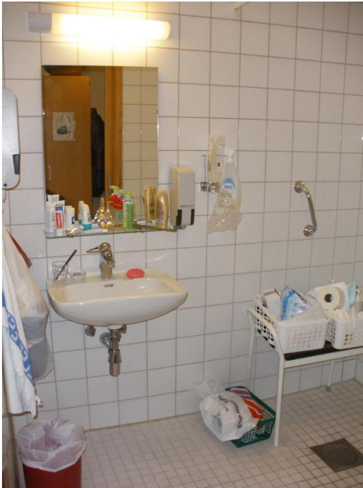
Bilde 6: Vask og deler av dusjområdet i baderom nr 1
