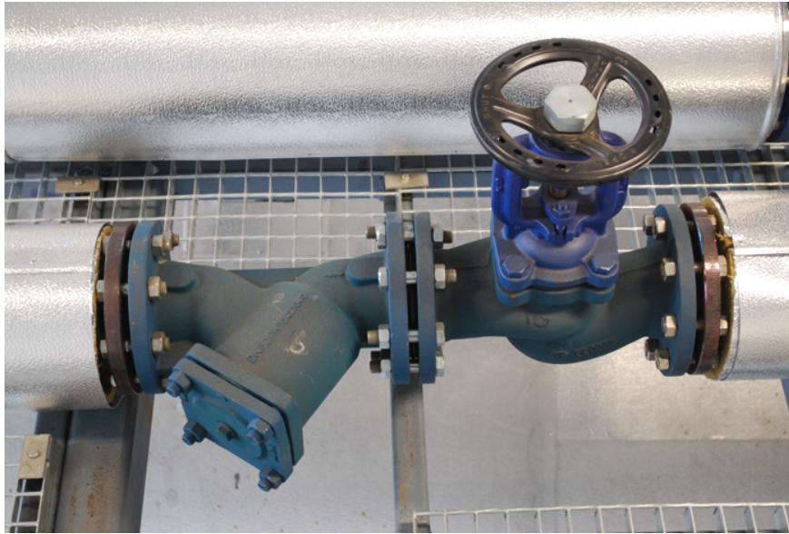
Figur 49 Uisolerte ventiler på TINE Meieriet Oslo.
