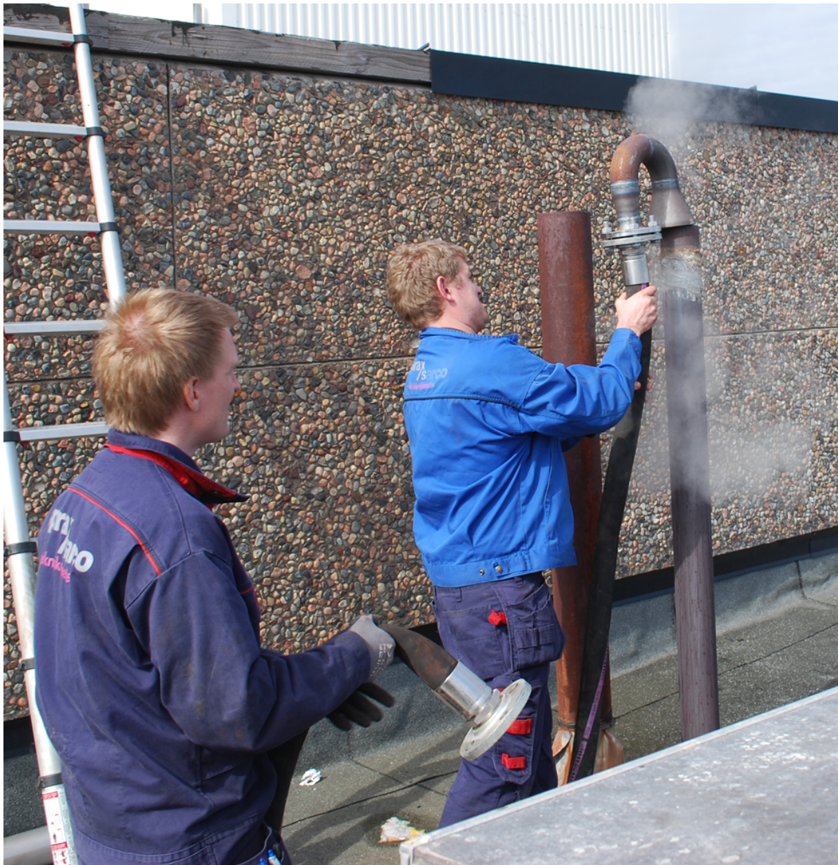
Figur 59 Studie av gjenfordampning i fra kondensattank TINE Meieriet Oslo.
