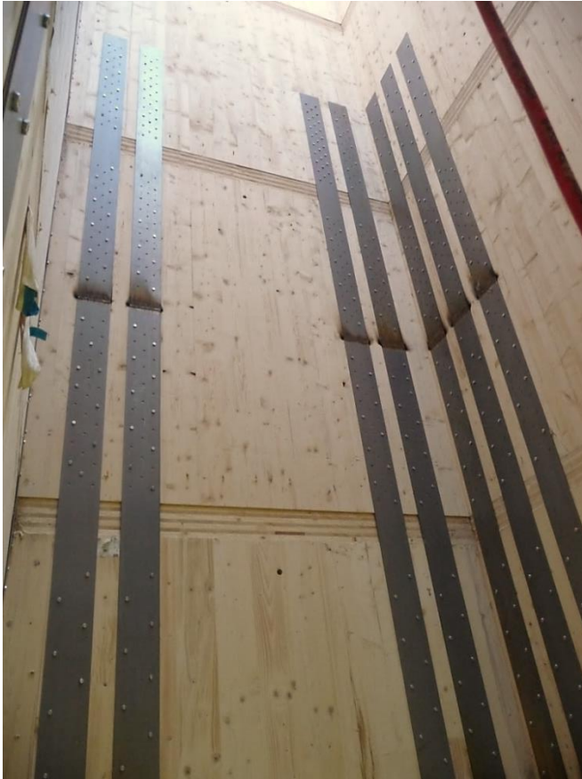
Figur 3: Avstivende stålbeslag i Palisaden. Bildet er tatt i heissjakten.
