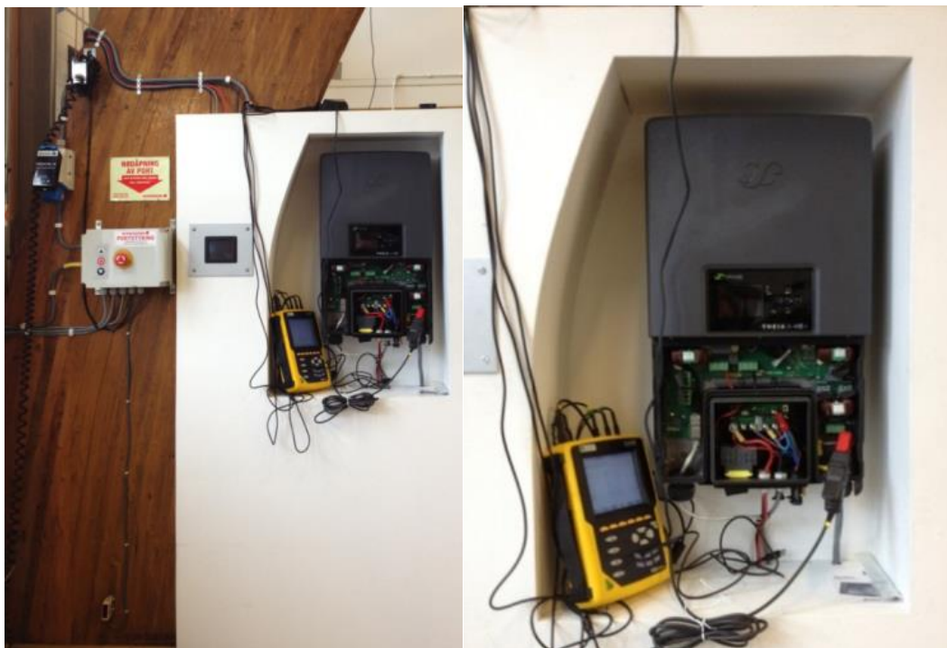
Figur 3.4 viser vekselretter, og begge nettanalysatorer oppkoblet på nettet. I venstre bilde sees Medcal N helt til venstre. I høyre bilde ser man Qualistar+ og oppkobling av strømtang på uttaket fra vekselretteren. Foto: Anette Ellingsen.
