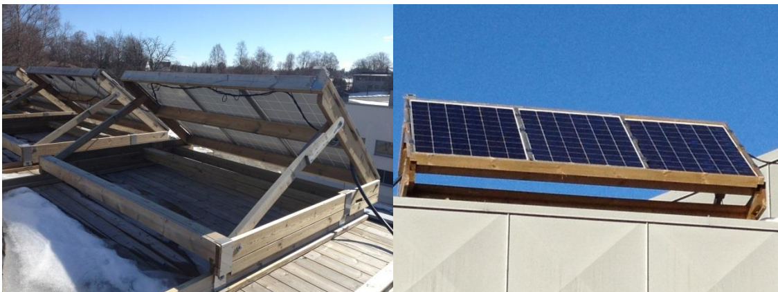
Figur 2.10 viser forside og bakside av solcellepanelene som er montert på justerbare trerammer. Til venstre vises baksiden av panelene og monteringsløsning hvor 3 og 3 moduler er koblet sammen og montert på én treramme. Til høyre vises fremsiden av tre solcellemoduler som er koblet sammen og montert på samme treramme. Foto: Anette Ellingsen.
