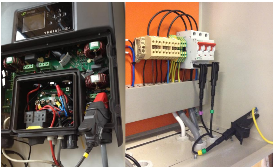
Figur 3.3 viser oppkobling av Qualistar+. Til høyre sees tilkobling ved uttaket fra vekselretteren og til venstre sees tilkobling i sikringsskapet. Foto: Anette Ellingsen.
