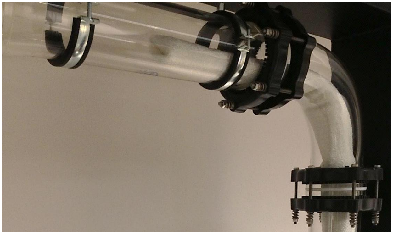
Figur 8 Illustrasjon av en situasjon med for lite trykkluft samt at bremsebåndet ikke er stramt nok. Foringen følger ikke rørveggen
