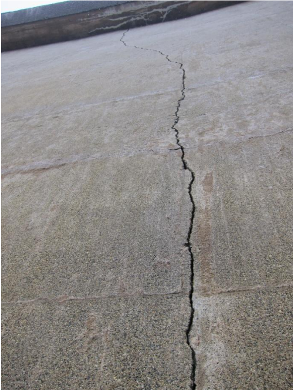
Vertikalt gjennomgående sprekk i frostvegg. 5-10mm i toppen.
