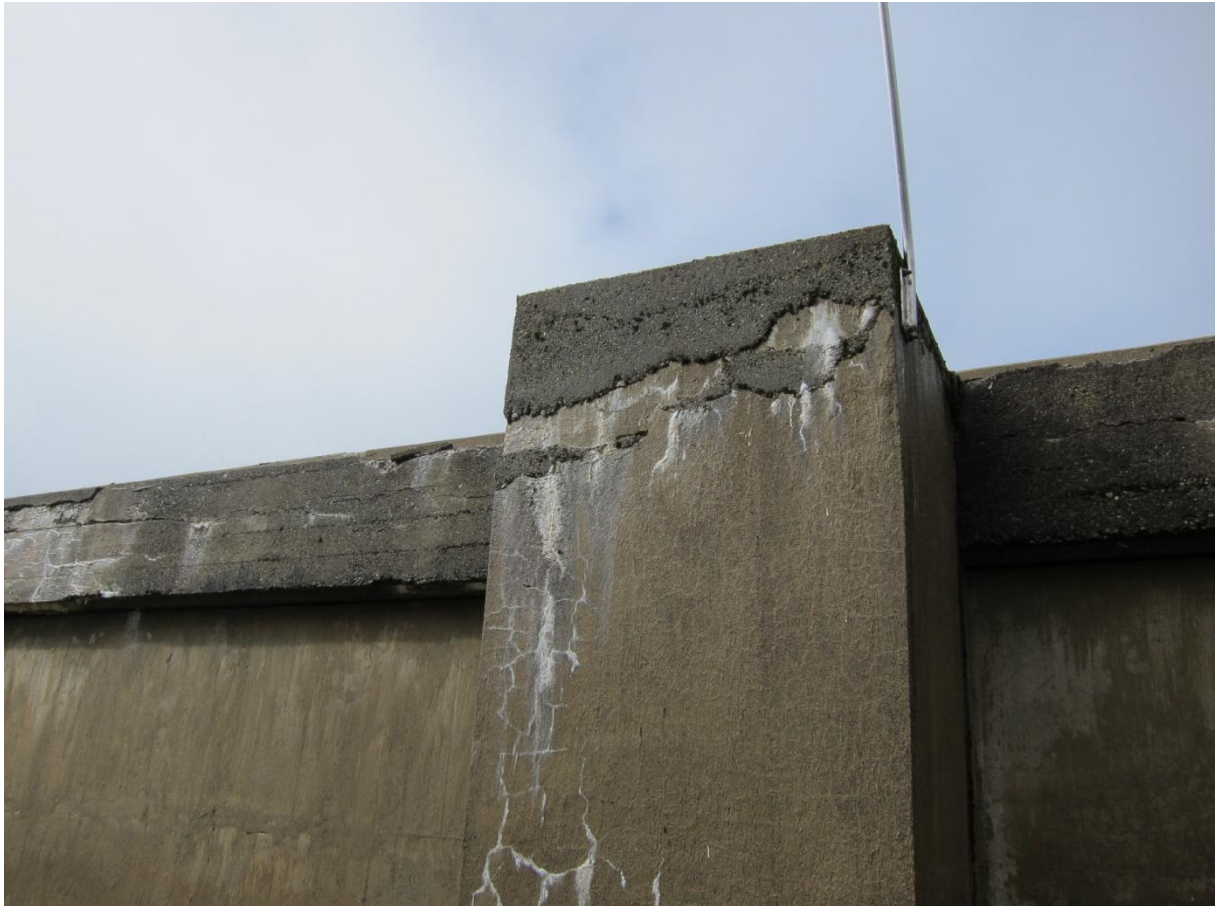
Figur 22 Bildet viser pilar med krakelering og ny reparert betong på toppen
