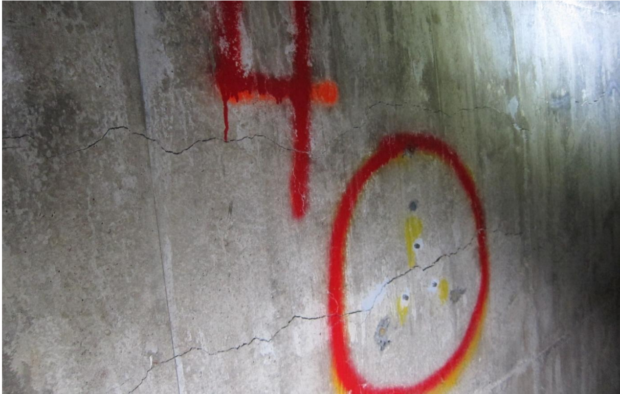
Tørre horisontale riss på damplate. Bildet viser målepunkt 4 til in-situ målesystemet som ble etablert på dammen på slutten av 90-tallet.
