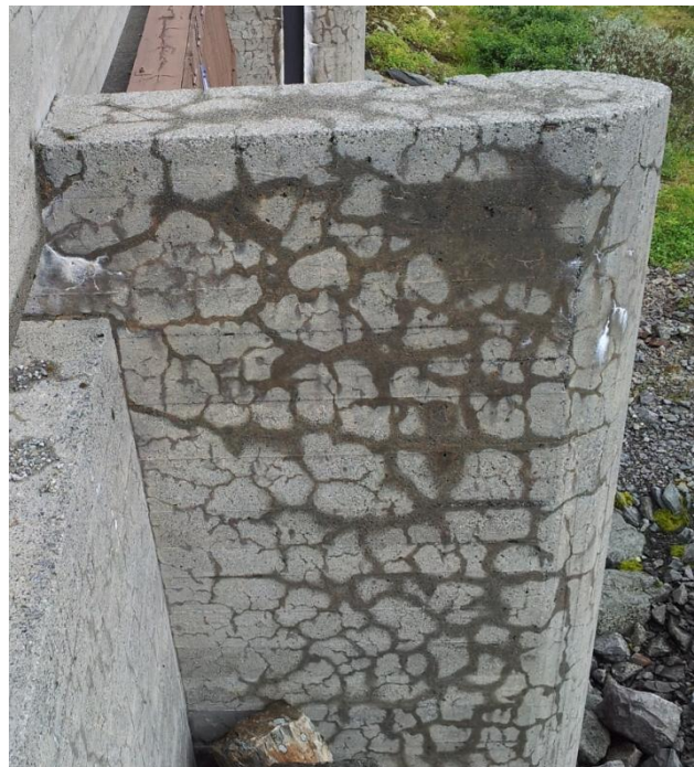
Figur 1 Typiske krakelingsriss forårsaket av alkalireaksjoner.
