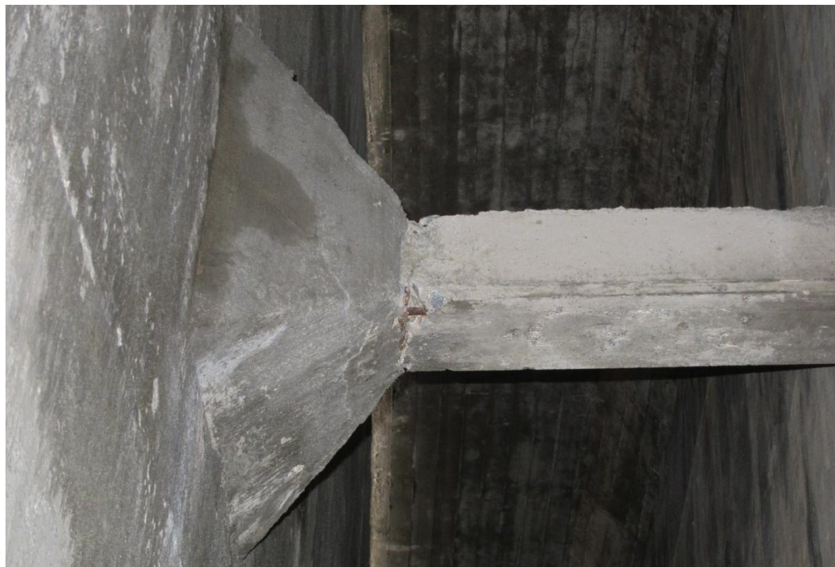
Brudd på betongbinder som holder frostvegg inntil damplaten. Tyder på større utvidelse av damplate enn frostvegg.
