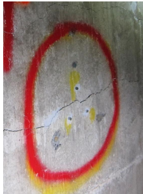
Figur 11 Dilatasjonsmålesystem av sprekk
