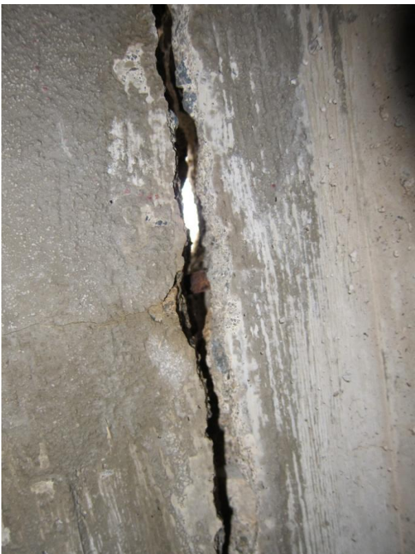
Sprekk i frostvegg fra innsiden.
