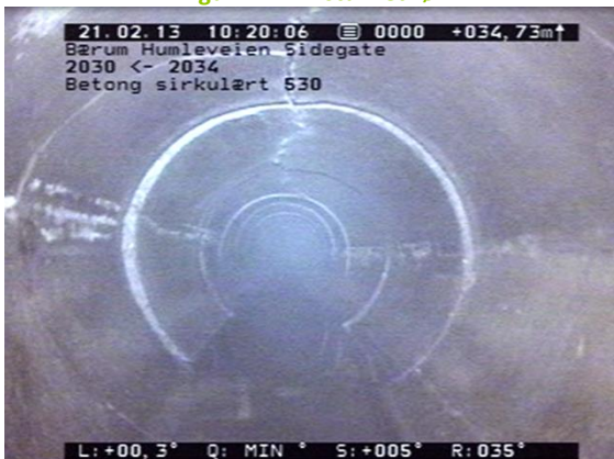
Figur 4-3: Deformasjon og sprukket rør
