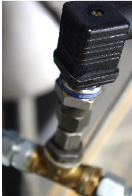
Figur 3.44: Trykksensoren vist tilkople, via et t-stykke, på hydraulikkompressorens trykkutgang.
