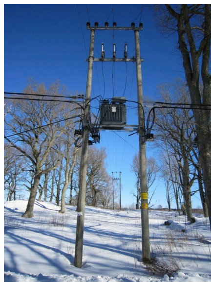
Figur 29 – Nettilknytningspunktet 17 kV/ 230 V til gården med 100 kVA transformator i mast. [2]
