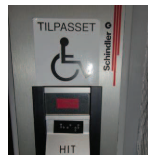
Figur 57 Heisen skal være godt merket
