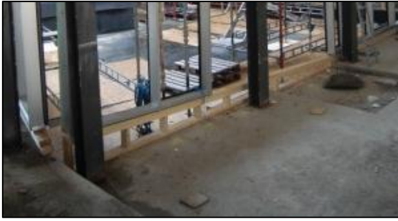
Bilde 5.4. Detalj av tilslutning mellom glassfasade mot skrå sokkel. Legg merke til løsningen med mye tre i sokkel til høyre i bildet. Dette er en mulig kuldebro.
