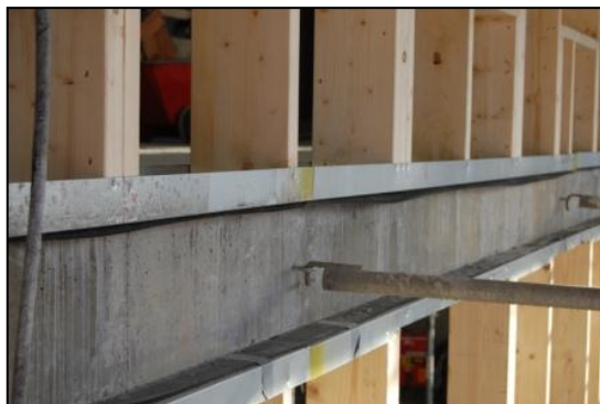
Bilde 6.1. Tilslutning dekke/ yttervegg i over- og underkant. Her er det benyttet stålsviller og uttrukket svillemembran.
