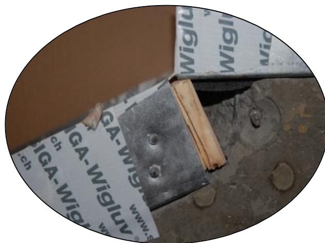
Bilde 5.2 og 5.3. Tetting mot skrå flater og knekkpunkter. Bildet viser stålvillen i et kritisk punkt. Skjøten er tettet med teip.
