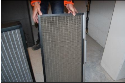
Figur 2.20. Ventilasjonsfilter i sentralt installert system i et boligbygg hvor kontraktsforhold for drift og vedlikehold av anlegget ikke har blitt ivaretatt. Filteret som i utgangspunktet skulle vært byttet to ganger årlig har her ikke blitt byttet på over et år. Bildet er tatt etter at vaktmesteren har ristet filteret, så det har vært enda verre enn bildet viser.
