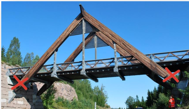
Bilde 41 - Hvor man bør måle for fukt, ved store ansamlinger av kreosot
