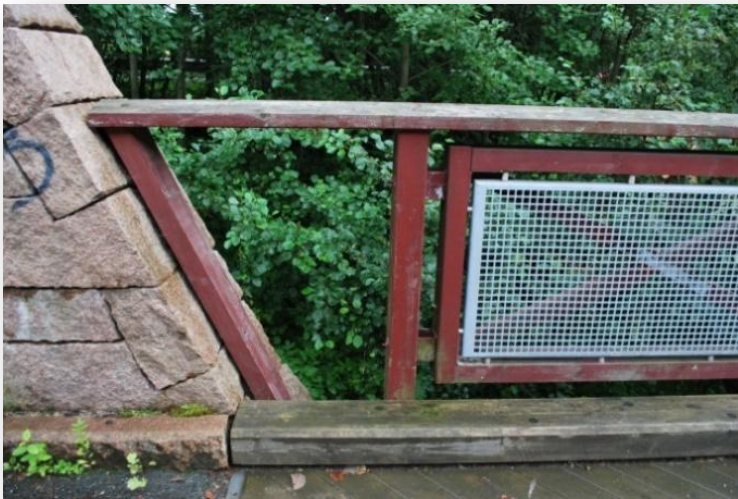
Bilde 30 – Skruer mangler i innfestingen, Høiendahl
