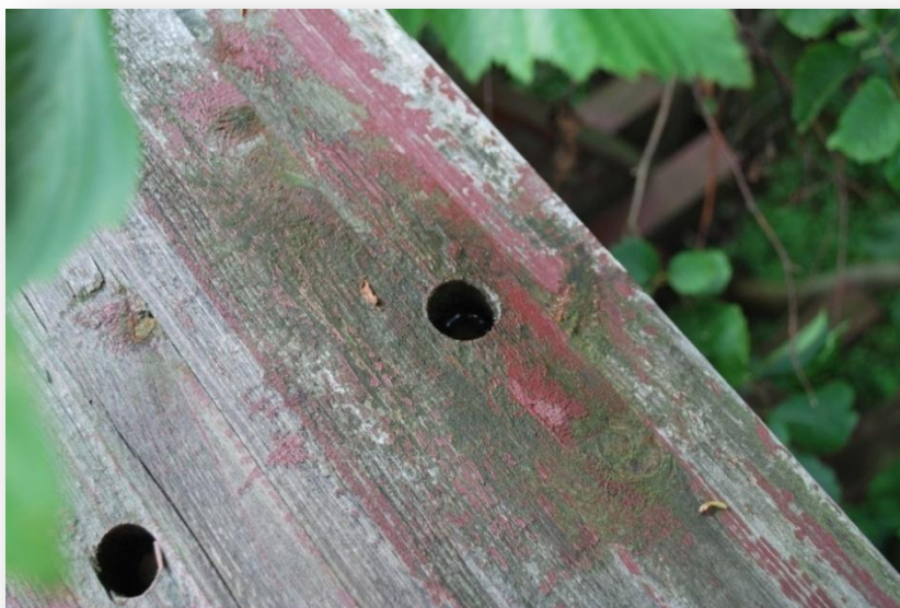
Bilde 27 – Hull i rekkverk, Ulnes
