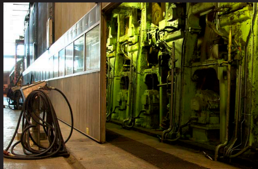
Fig 1.9: 1 av 3 papirmaskiner i produksjonshallen.
