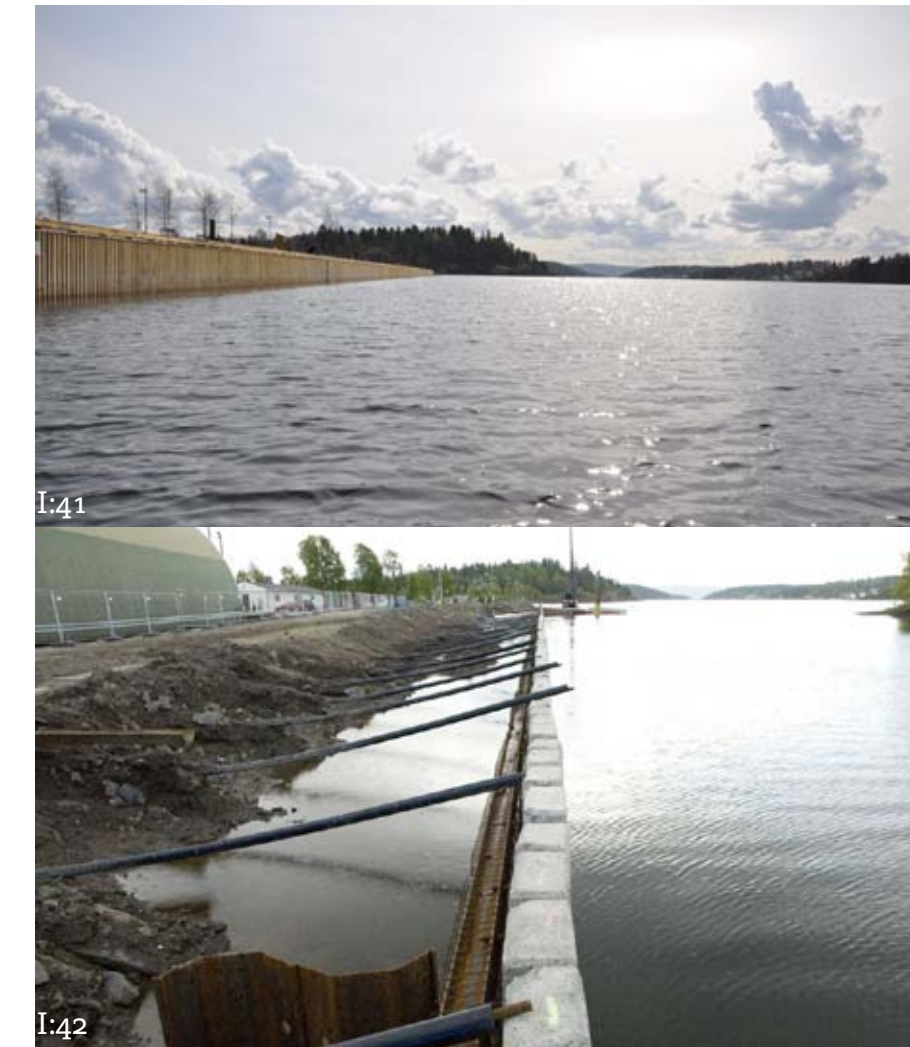
Konstruksjon Snittet nedenfor viser et konstruksjonsprinsipp som ble brukt på gjestebryggen på Kadettangen i Sandvika. (Se bildene) Bruk av spuntvegg i stål gjør at bryggeanlegget med turvei kan legges direkte på denne konstruksjonen med stabiliserende masser. Spuntveggen kan på samme tid være erosjonssikring, og en måte å hindre utgliding av massene fra søppelfyllingen på. Om ikke spuntvegg er en holdbar løsning, kan spuntpeler være et alternativ, men da må man bruke en annen løsning for erosjonssikringen, f.eks steinblokker som stables for å oppnå riktig helning. Bryggen har et "skjørt" hele veien ned til vannet.
