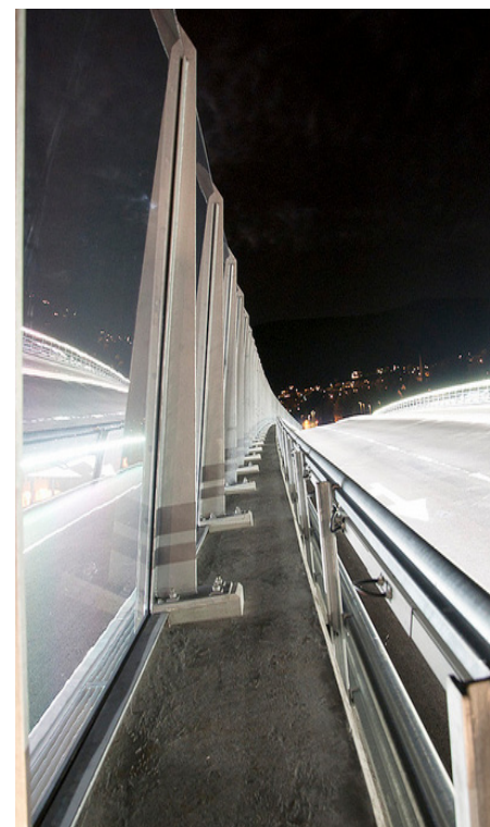
Figur nr. 130 Broens støvyavskjerming og belysning
