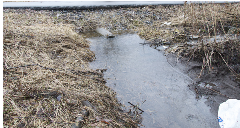
BEKKELØP SOM KOBLER SEG PÅ LUSETJERBEKKEN VED INNLØPET. MANGEL PÅ INFILTRASJON DER VANNET GÅR I RØR RESULTERER I KAPASITETSPROBLEMER VED UTFLØPETS GRUNN NÅR VANNFØRINGEN BLIR STOR. FOTO: EGET
