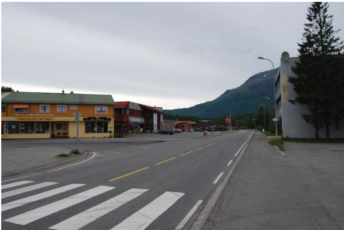
Fig. 4.16 Setermoen sentrum før rehabiliteringen av Statens vegvesen. Området er preget av nedslitte kantstein, forskyvninger i belegget og manglende nedsenkning fremfor gangfelt (Wikipedia 2008).
