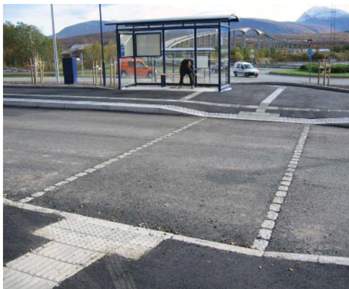
Fig. 4.10 Nedsenket gangfelt på motsatt side er for bratt i forhold til kravene (Haagensen 2009).
