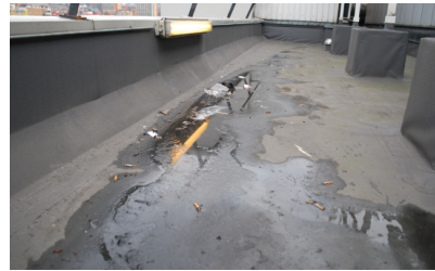
Illustration 77. Fallet är 1:60 över stora delar av taket. Brunnarna ligger längs takets norra sida.
