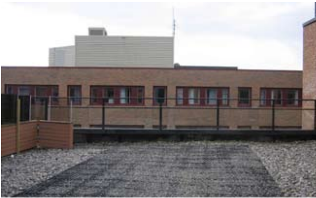
Figur 98: Tilgjengelig område i Ski Amfi. Det er et lite areal som er blitt gjort tilgjengelig.
