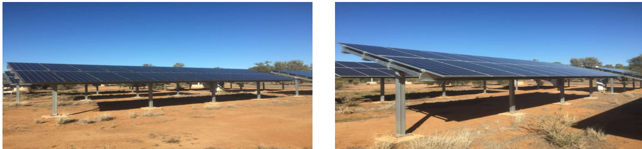
Figur 3.4: Solcellemodulene som utforskes ved DKASC. Til venstre vises anlegg 24, og til høyre vises anlegg 25. Bildene er hentet fra DKASC (henholdsvis udatert-b, udatert-c).
