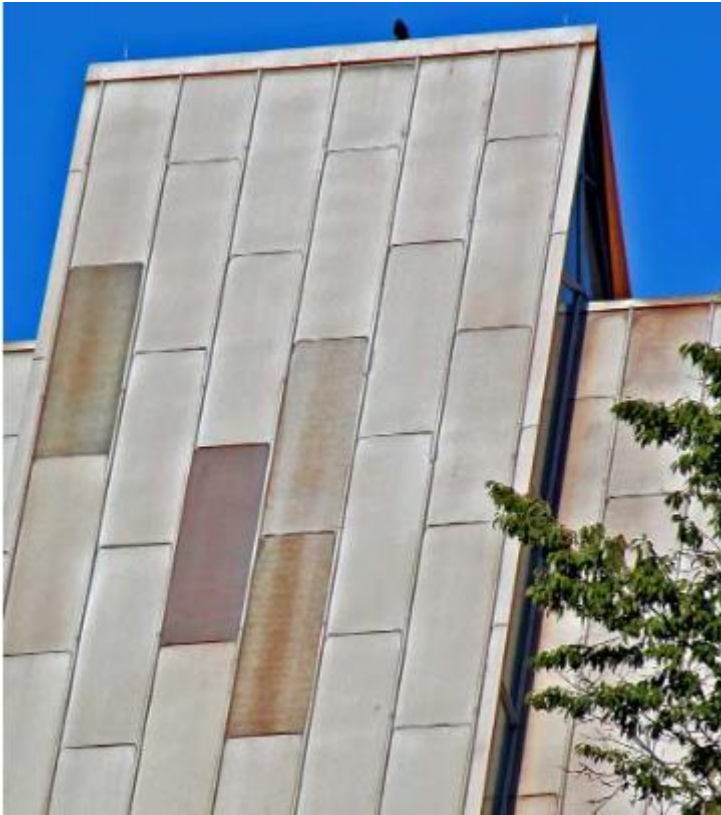
Figur 13: Takpaneler av galvaniser stål som er korrodert av salt.
