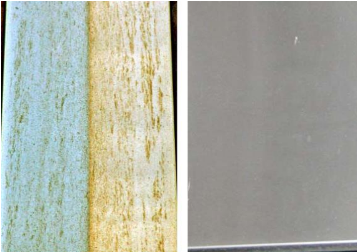
Figur 12: Panelar av rustfritt stål. A2- typen (venstre) har noko overflatisk korrosjon, og A4- typen (høgre) har ingen merkbar korrosjon.
