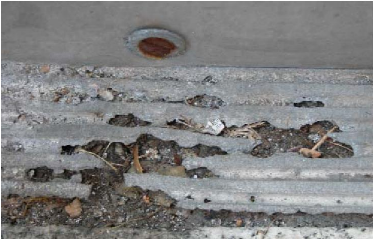
Figur 15: Dørterskel i aluminium som er blitt sterkt korrodert av salt.
