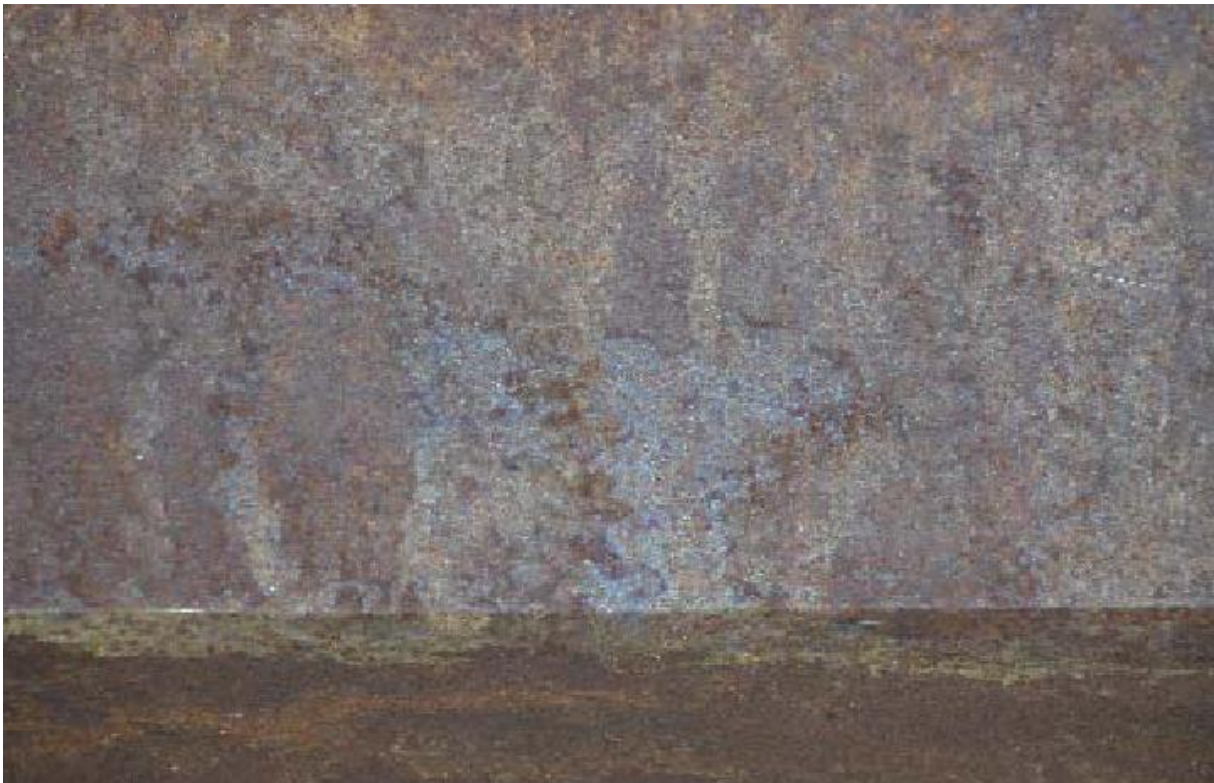
Figur 14: Cor-ten stål på utsida av ein bygning som har blitt skada av salting
