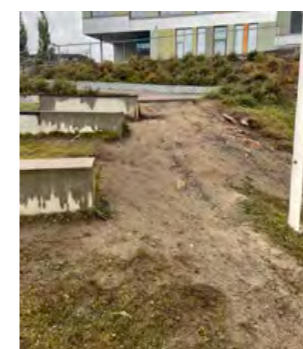
Slitasje i skråning
