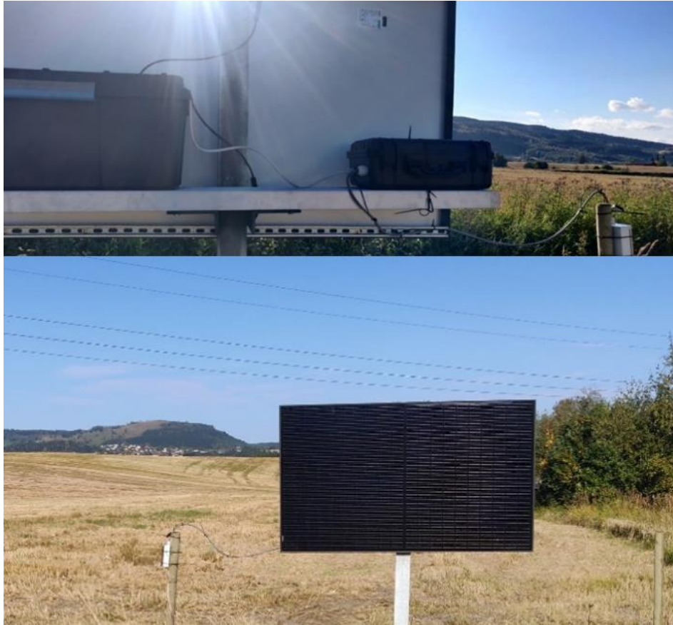
Figur 5: Oppsett av solcellepanel med batteri, «readerboks» og «tunerboks» fra venstre til høyre. «Tunerboksen» er satt på stauren til høyre for solcellepanelet.
