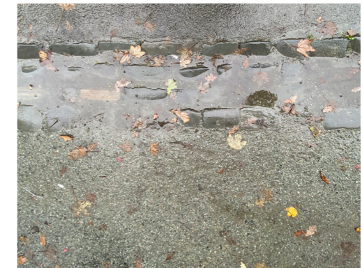
Figur 2.67 Vannrennen er fylt til bristepunktet ved en gjennomsnittlig regnværsdag
