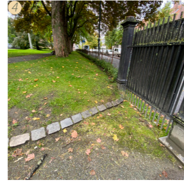
Figur 2.21 Anlagt gangfelt ved hovedinngangen til Domkirkegården er bredere enn inngangsporten, og grusfeltet gror igjen av mose.
