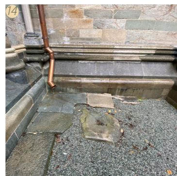
Figur 2.31 Det er flere åpne taknedløp rundt Nidarosdomen, men det mangler fungerende vannrenner og videre føring av takvannet.
