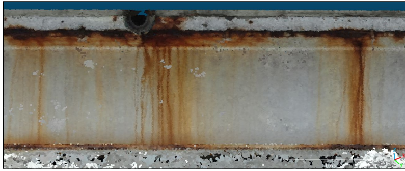
(a) H-bjelke i ytterkant av brua med tydelig rust i toppen, samt avrenning av rust ned på bjelkene.
