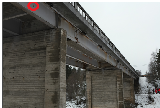
(b) Skråbilde med rustfleck i hjørne av bildet
