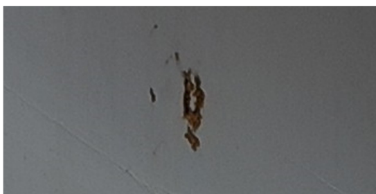
(c) Rustfleck i midten av bilde
