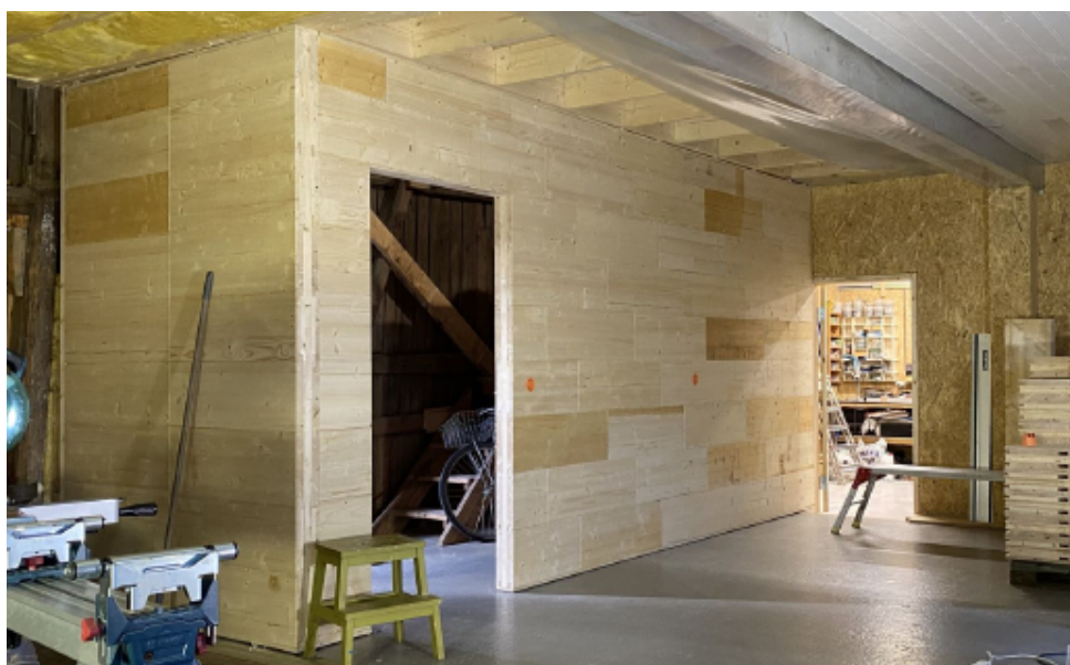
Figur 3-20. Ferdig montert hjørnevegg med døråpning og skjult elektrisk anlegg oppført i snekkerverkstedet.
